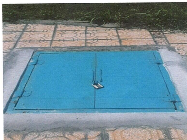
Hố ga thu gom, thoát nước thải
