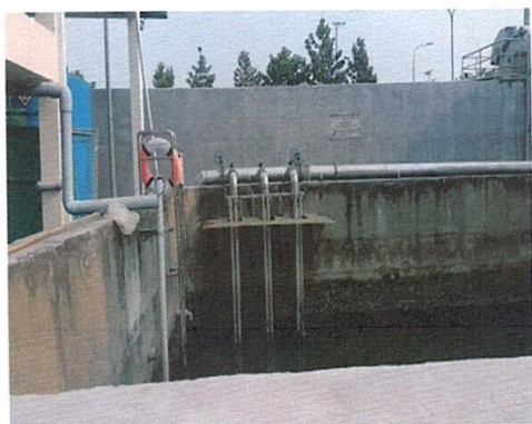
Bể gom nước thải
