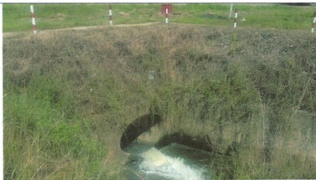
Cống xả nước mưa + nước thải từ Khu dân cư xã Tây Hòa vào mương hồ của KCN
