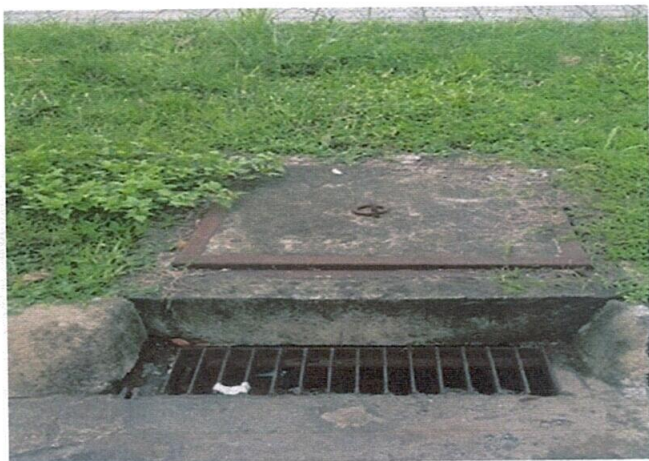
Hố ga thu gom, thoát nước mưa
