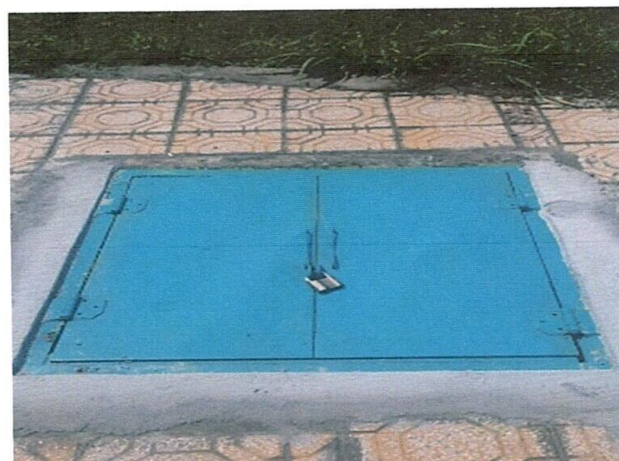
Hố ga thu gom, thoát nước thải
