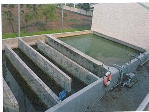
Bể khử trùng + Bể phân hủy bùn
