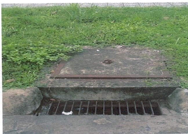
Hố ga thu gom, thoát nước mưa
